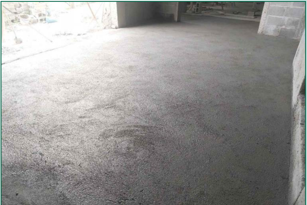
Fundición de 28 m2 de piso de concreto en área vestíbulo de acceso
